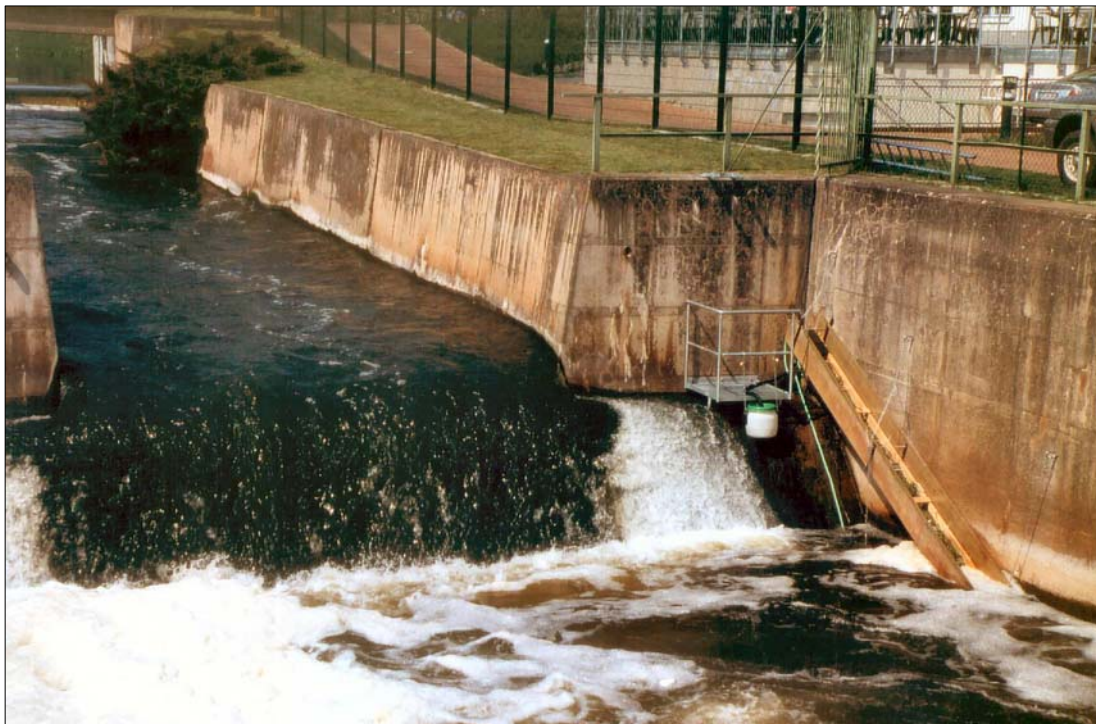
Abb. 2.4.1.1: Steigaalfangrinne in der Uecker (Mecklenburg-Vorpommern)
