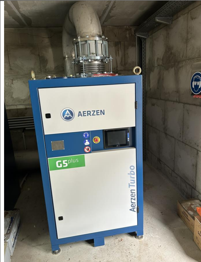
Einer der beiden baugleichen Turbo-Druckluftgebläse.
